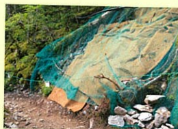
ネット設置の応急措置がとられた崩落箇所
